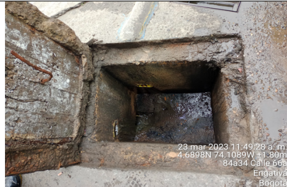
Fotografía No 4. Caja de inspección interna
