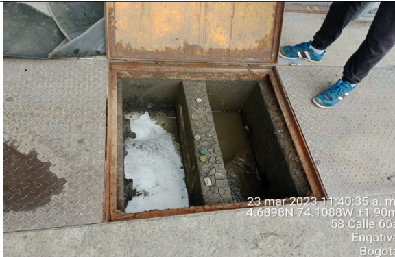
Fotografía No 3. Trampa de grasas
